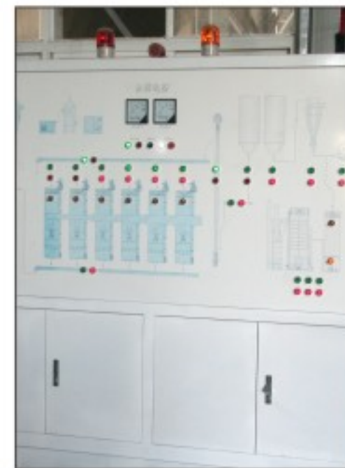
干燥机控制系统 DRYER ELECTRICITY CONTROL SYSTEM
